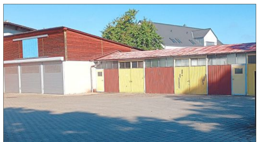
Die Gebäude sind laut Wasserwirtschaftsamt sanierungsbedürftig, der Platz nicht mehr ausreichend.
